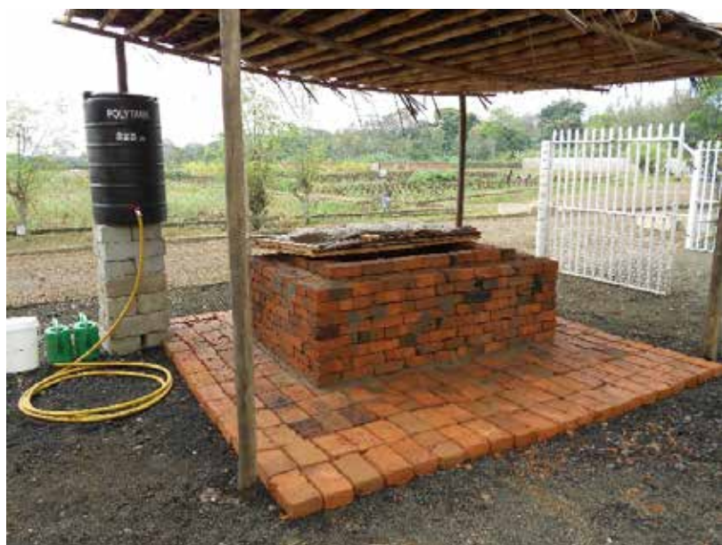
Chambre froide zéro énergie (ZECC) améliorée avec une alimentation en eau et un auvent à Arusha (Tanzanie). Crédit photo: Lisa Kitinoja/ Postharvest Education Foundation
